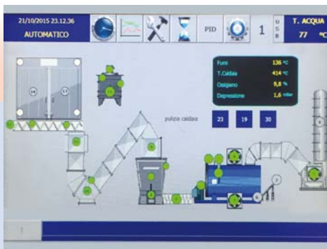
PANNELLO QUADRO ELETTRICO GENERAL CONTROL PANEL
